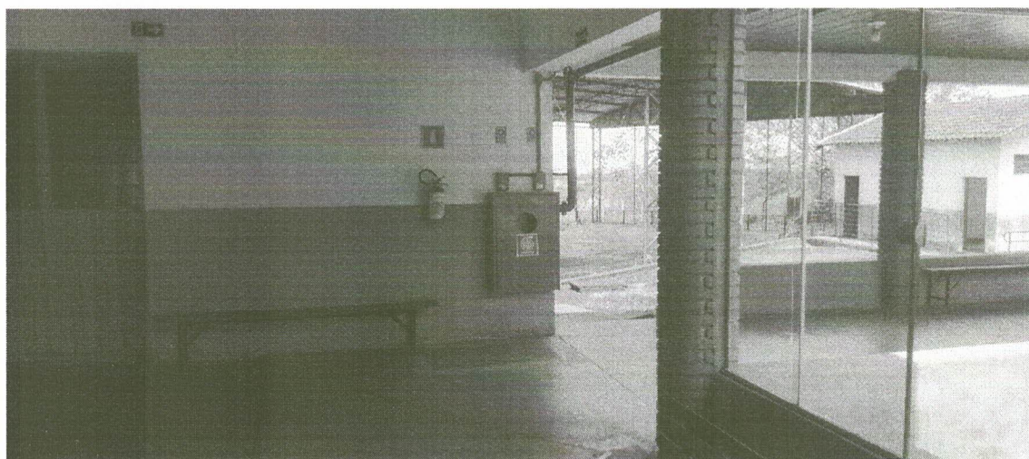
Figura 2 - Hidrante pátio interno
